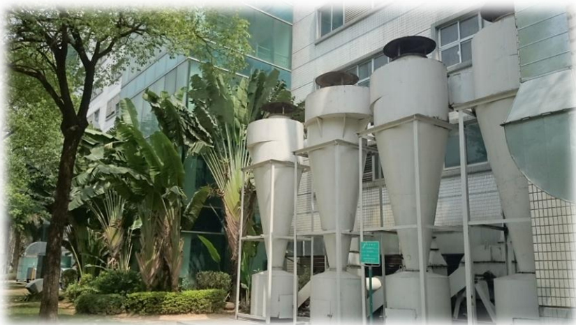
鞋底磨邊打粗粉塵，裝設旋風集塵器，有效集塵。
